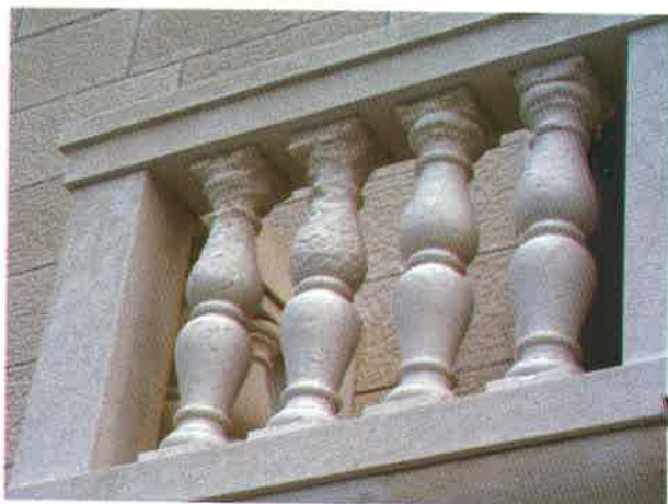
Sl. 1. Prikaz kamenih stupića (kolonada) na balkonu. Oštećenja su učestala ispod poklopnice (koportele). Pučišća (2006.g.)
