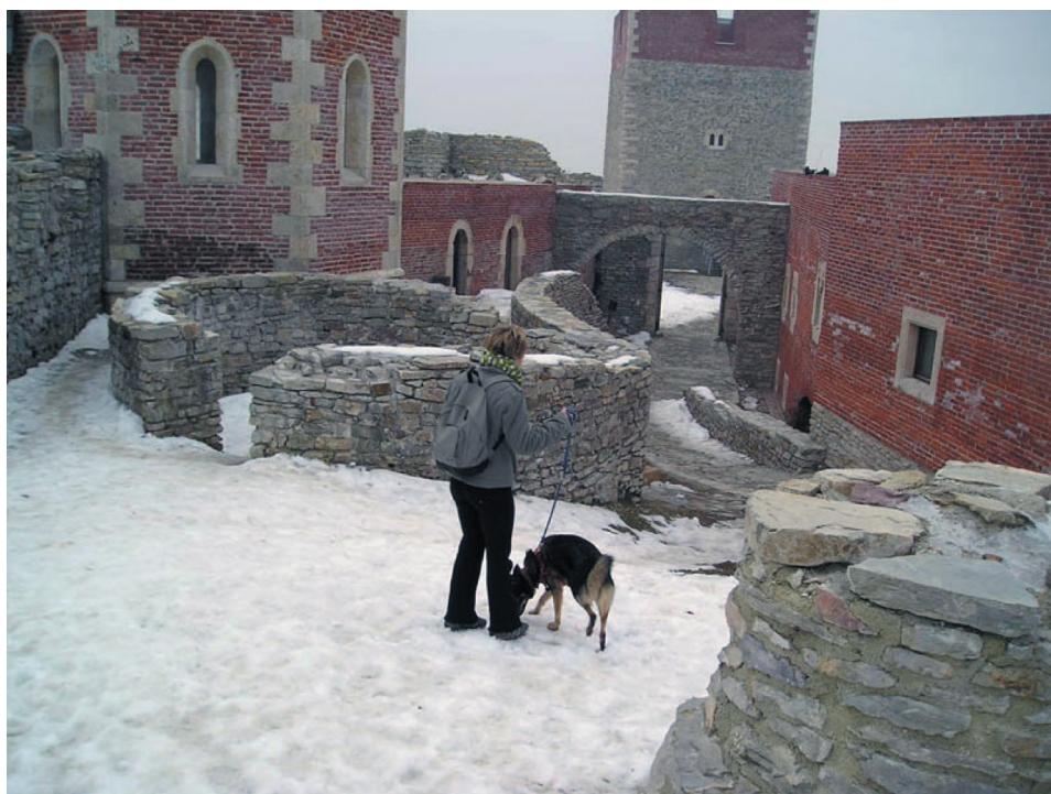
Slika 8. Oštećenja na dijelovima zidina Medvedgrada
