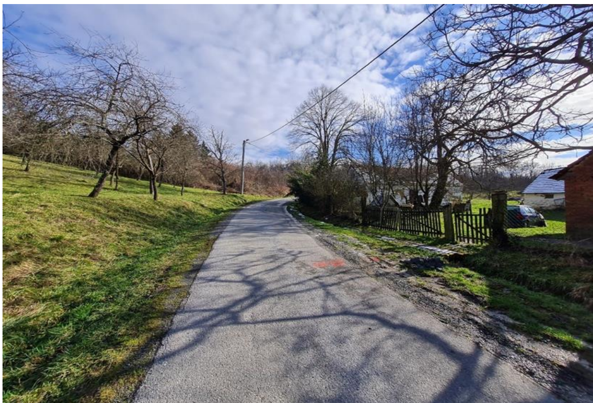
Slika 4-4. Usijedanje prometnice na lokaciji 3, oko stacionaže 1+050
