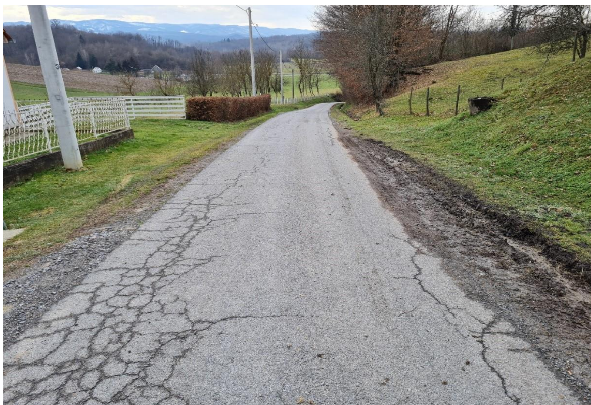
Slika 4-2. Lokacija 1 oko 0+500 na županijskoj cesti ŽC 4043
