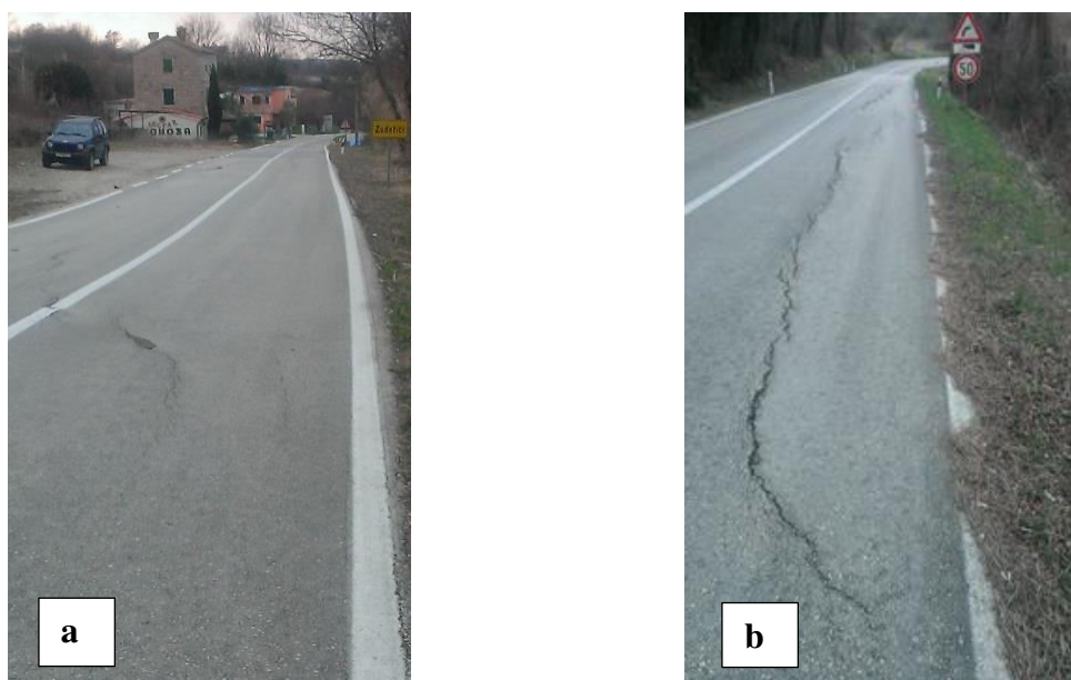
Slika 3.6. Pukotine na cesti ŽC 5209 koje ukazuju na klizanje unutar nasipa (snimio M. Krkač 8.5.2015.): (a) pukotina na stacionaži 0 + 650,00; (b) pukotina na stacionaži 0 + 850,00.
