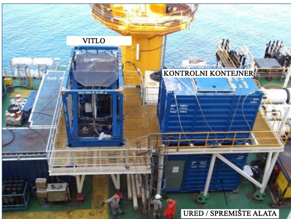
Slika 4-9. Ured i kontrolni kontejner (Rajabi et al., 2012).
