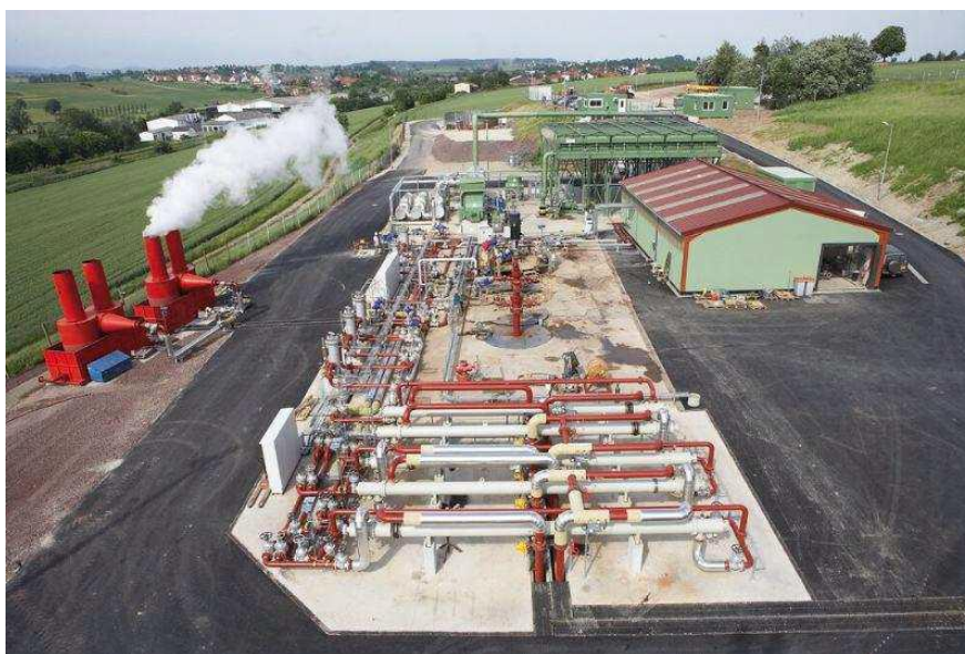
Slika 5-1. Geotermalna stanica Soultz: jedinica za napajanje (u pozadini), 3 geotermalne bušotine (u sredini), geotermalna petlja za hlađenje (naprijed) (FinalReport EGS Pilot Plant, 2009.)
