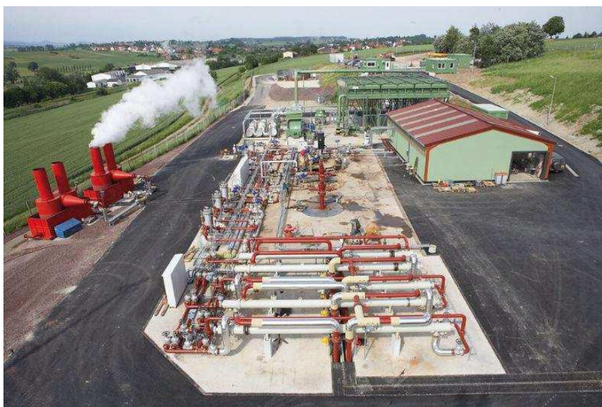
Slika 5-1. Geotermalna stanica Soultz: jedinica za napajanje (u pozadini), 3 geotermalne bušotine (u sredini), geotermalna petlja za hlađenje (naprijed) (FinalReport EGS Pilot Plant, 2009.)
