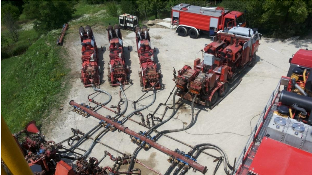
Slika 2.6. Visokotlačne pumpe i tlačna crijeva (Škrinjarić, 2015)
