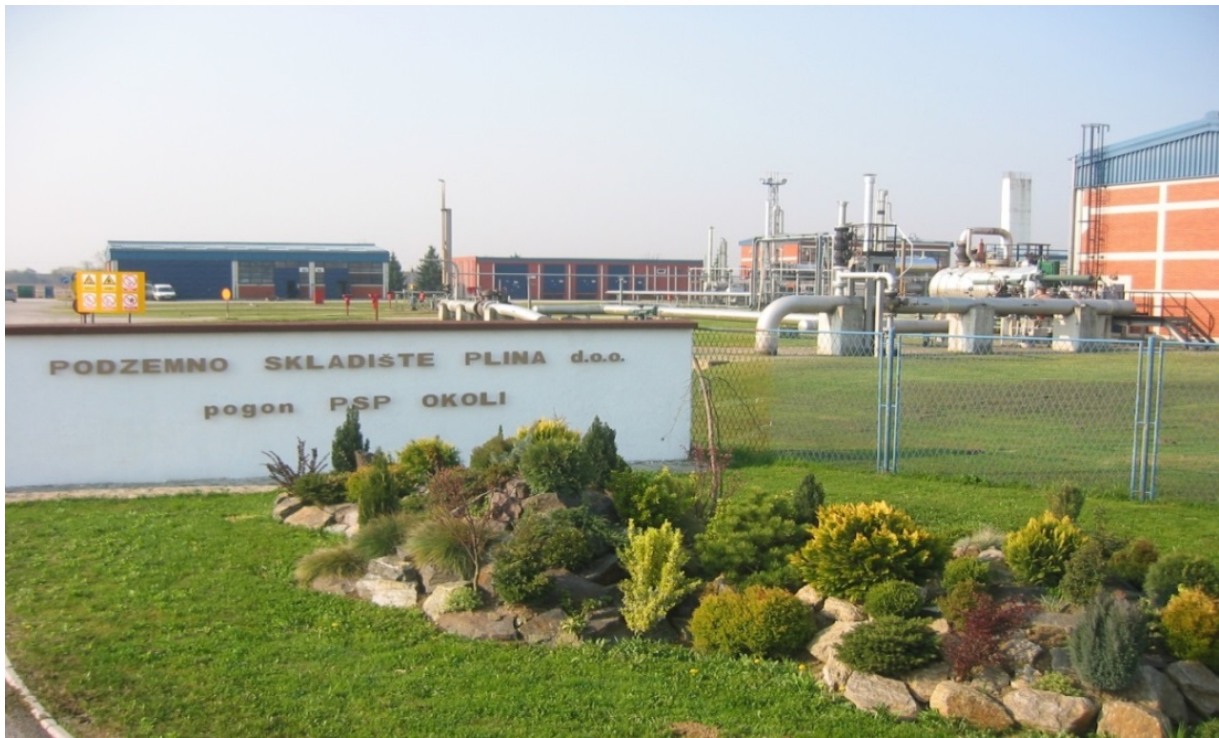
Slika 2.6: Podzemno skladište plina Okoli, Hrvatska ( https://psp.hr )
