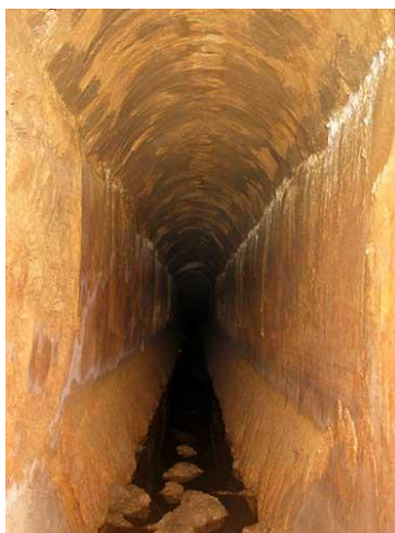
Slika 3.1.3. Tunel akvedukta. (preuzeto iz: KONZERVATORSKI ELABORAT zaštite i obnove Dioklecijanovog akvedukta na lokaciji Brodarica-istok)
