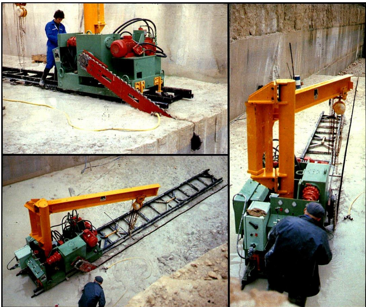
Slika 2-2. Lančana sjekačica francuske tvrtke Perrier pri piljenju horizontalnog reza u kamenolomu (Kujundžić et al. 2003).
