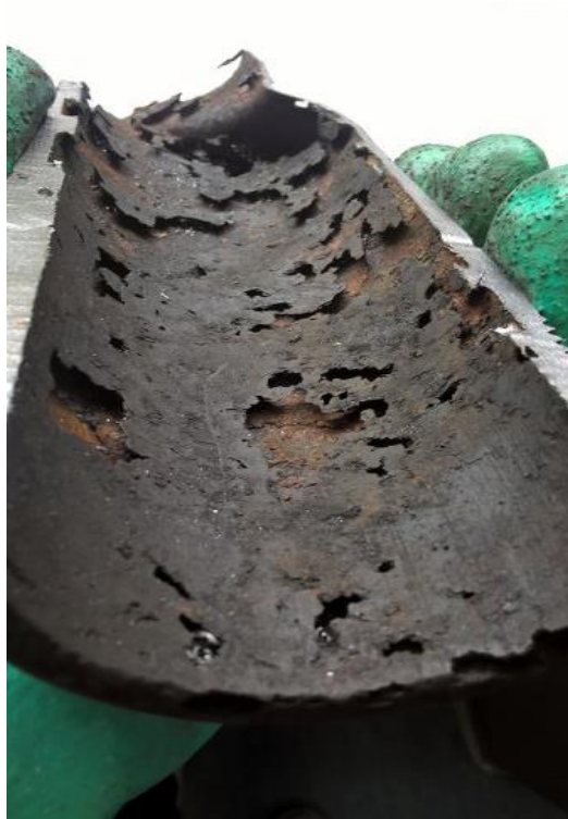
Slika 4-5. Proizvodni niz cijevi oštećen djelovanjem korozije (INA d.d., 2017 b)
