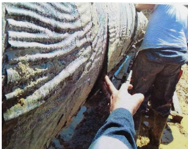
Slika 5-7. Oštećenje polietilenske trake (JANAF D.D., 2016)
