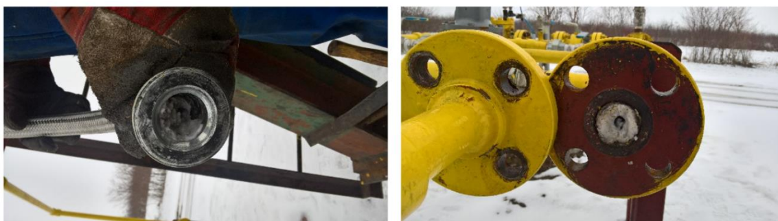
Slika 4-5. Zamrzavanje kondenzata u usisnim i tlačnim instalacijama (INA d.d., 2018a)
