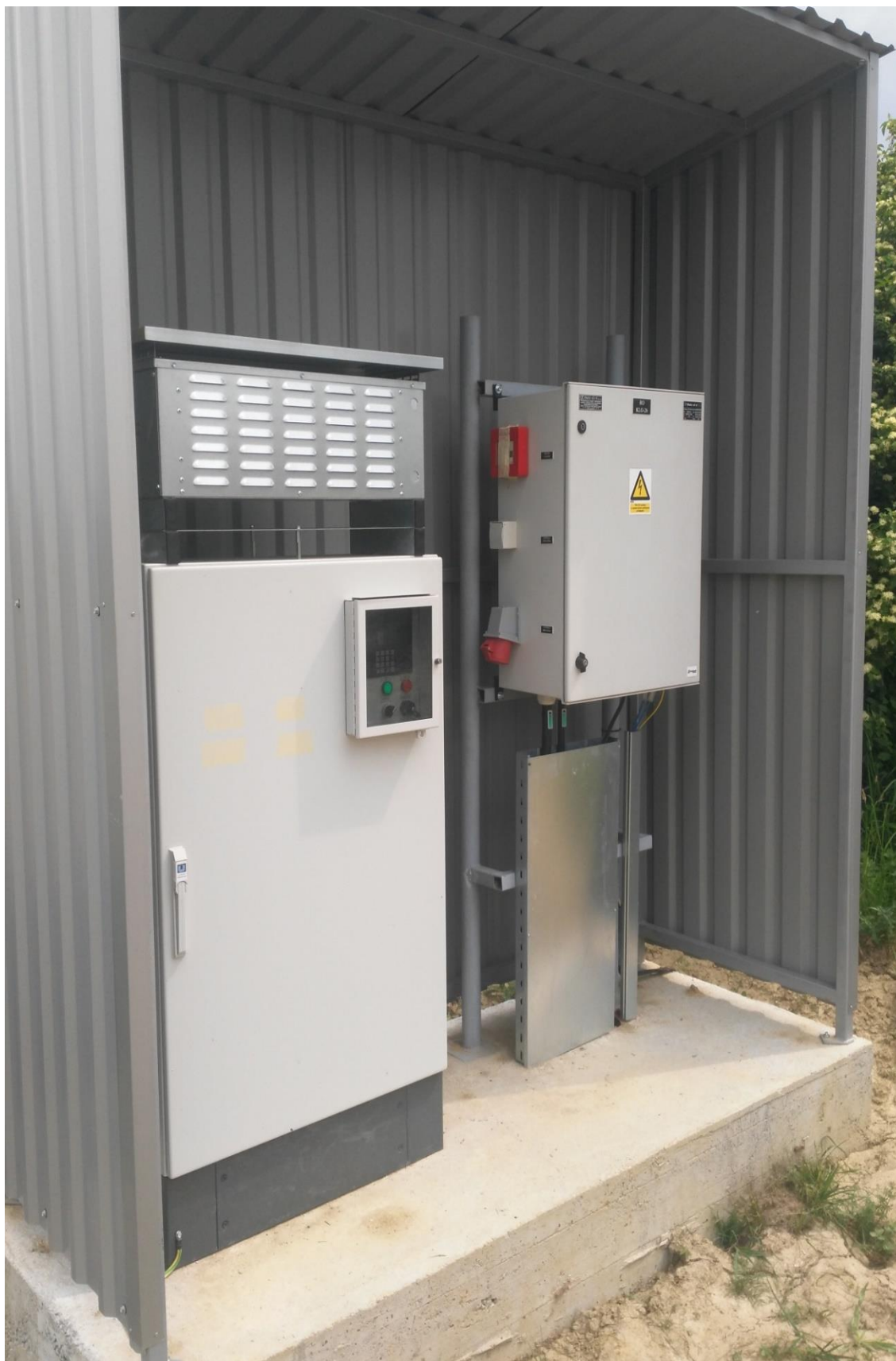
Slika 5-6. Razvodni ormar i LRP regulator na bušotini X-1
