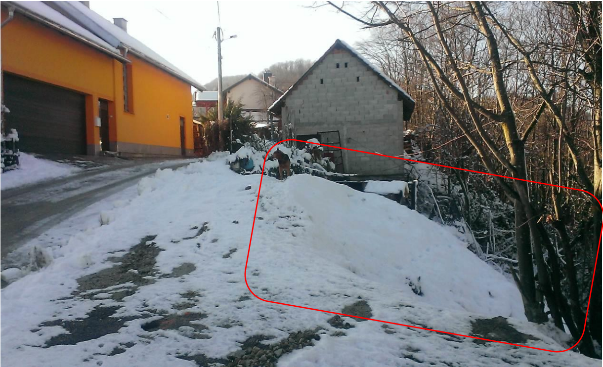
Slika 3.4 Klizište Cerina 3: (fotografirano 31.1.2014.): pogled na čeonu pukotinu i zonu usijedanja.
