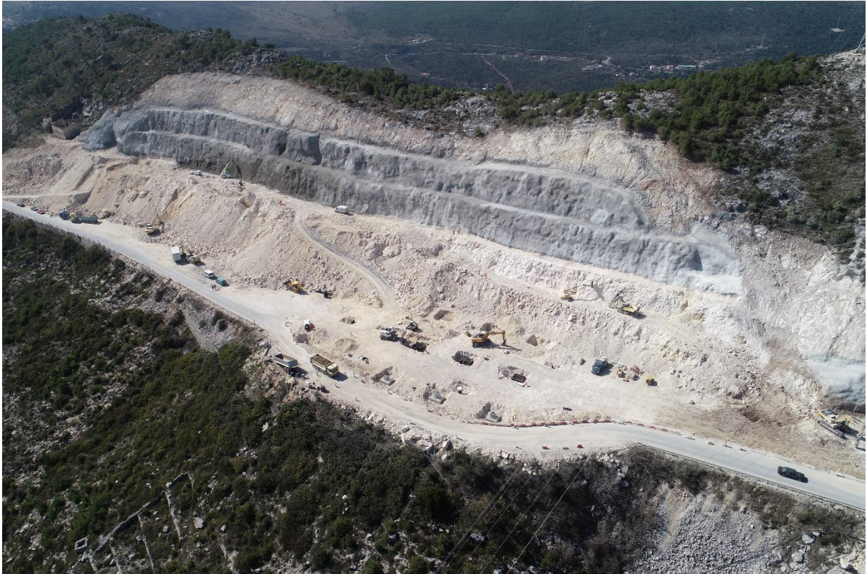
Slika 5.2 Fotografija snimljena dronom na gradilištu stalnog graničnog prijelaza Gornji Brgat s vidljive tri otkopane etaže, dvije torkretirane betonom i jedne zaštićene mrežom (gornja etaža)
