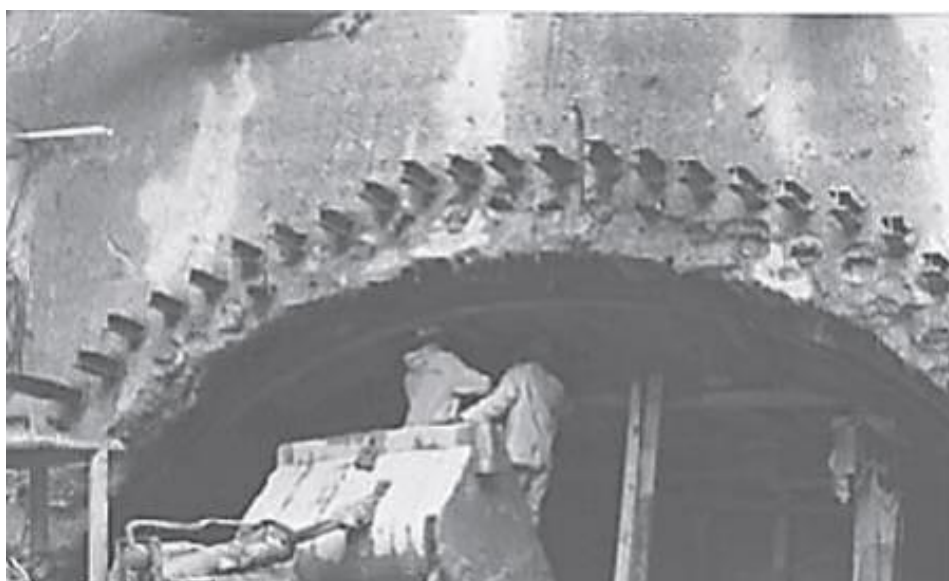
Slika 2-28 Podupiranje iskopa tunela I profilom (Smjernice za projektovanje, građenje, održavanje i nadzor na putevima, 2019)
