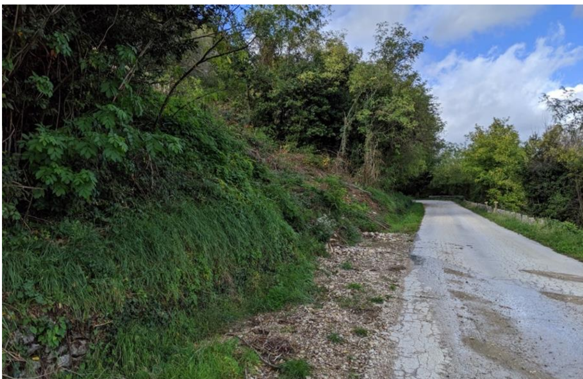
Slika 2.4. Fotografija oštećenja obložnog zida drenažnog kanala nastalog uslijed klizanja te nožice klizišta, promatrane od J prema S (fotografirano 4.11.2019).
