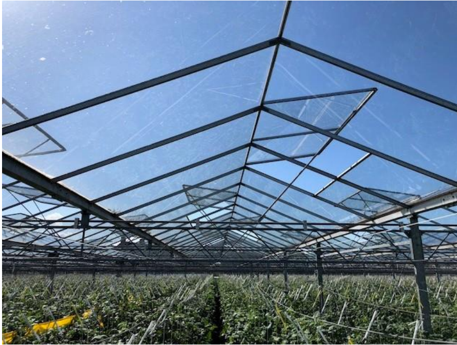
Slika 7-4. Unutrašnjost staklenika "Venlo" (HortiUsed, 2020)
