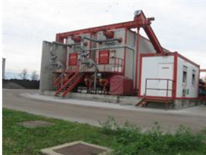
Slika 3.46: Postrojenje za obradu komposta, preuzeto od ZGOS
