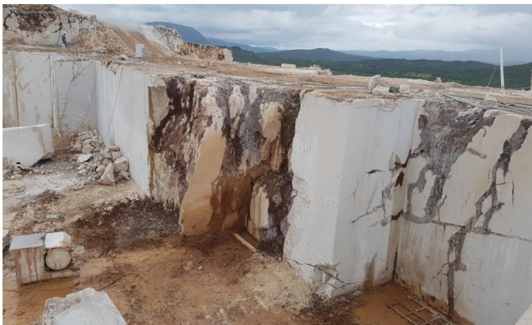
b) otvorene pukotine, zapunjene crvenicom, na čelu etaže
