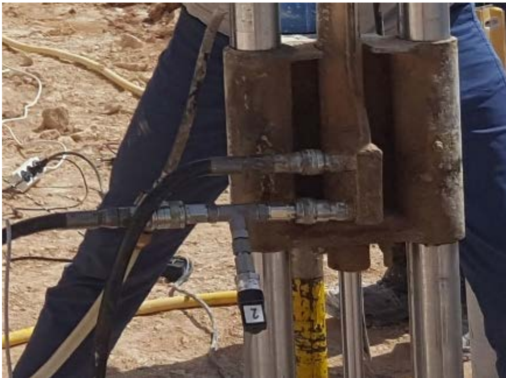
Slika 3.60. Mjesto spajanja osjetila za mjerenje tlaka na ulazni hidraulični vod
