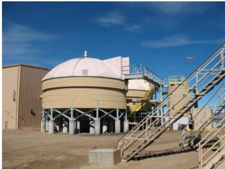
5-5. Flotacijska jedinica na terenu (Dahm i Chapman, 2014)
