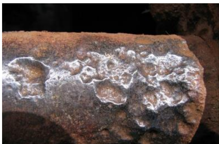
Slika 4-4. Vanjska korozija cjevovoda (corrosionpedia.com, 17.8.2020.)
