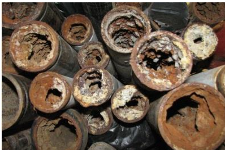
Slika 4-3. Unutarnja korozija cjevovoda (corrosionpedia.com, 17.8.2020.)
