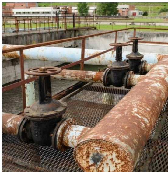
Slika 3-9. Primjer opće korozije ( https://corrosioncollege.com/resources/white-papers , 29.07.2020.).
