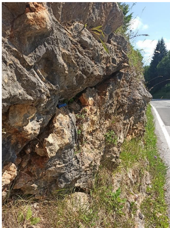
Slika 5-11. Donjokredni vapnenci u zasjeku državne ceste nedaleko od mjesta Prokop. Točka istraživanja T37, koordinate X=5504615 Y=5030156, Tablica I.
