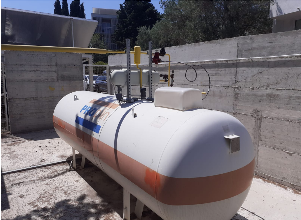
Slika 3-1. Nadzemni spremnik u sklopu jednog hotela na Korčuli
