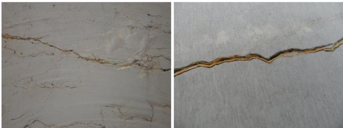
Slika 7.39. Prikaz nezapunjenih pukotina, s lističavim ljepilom
