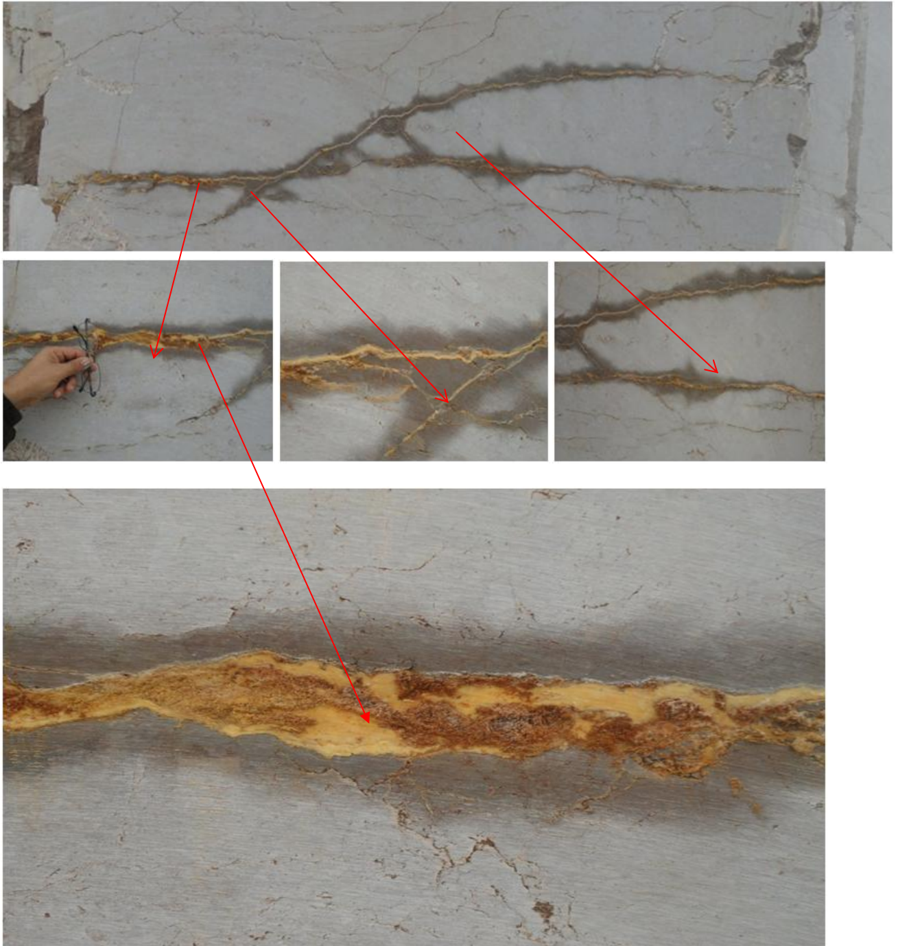
Slika 7.38. Prikaz zapunjenih pukotina
