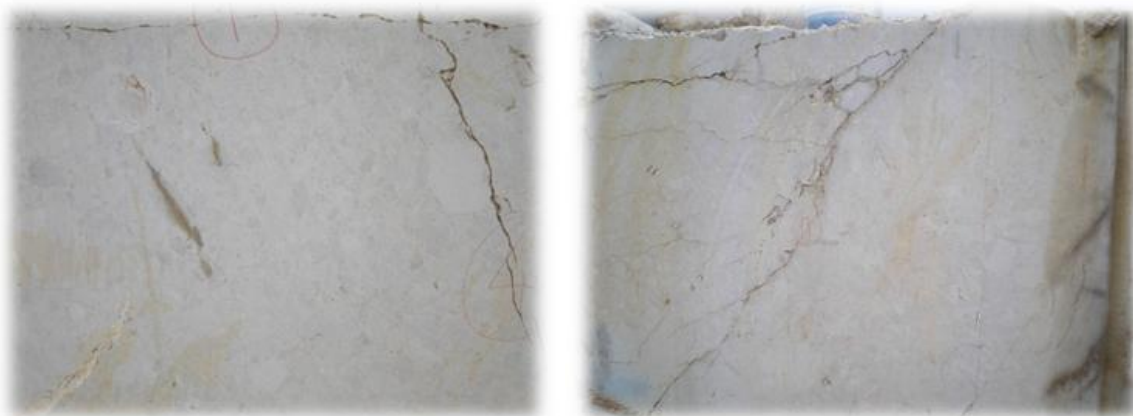
Slika 7.8. Pukotine oznake 1 i oznake 4 evidentirane na zapadnom čelu
