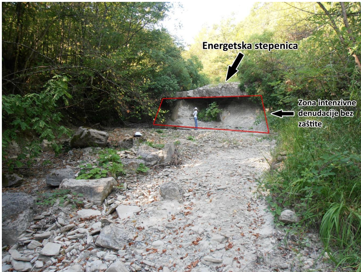
Slika 152 – Nezaštićena energetska stepenica u slivu 9
