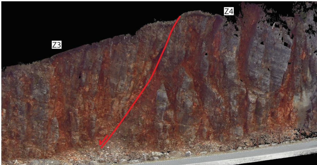
Slika 4.41. Podjela dijela stijenskog zasljeva na lokaciji Špičunak na dvije zone gdje granicu između zona predstavlja normalni rasjed pri čemu je vidljiva razlika u stupnju trošnosti stijenske mase i u geometrijskim značajkama diskontinuiteta u svakoj pojedinoj zoni.
