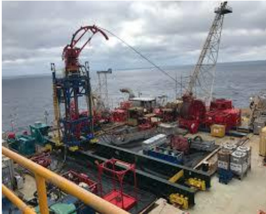
Slika 3-2. Odobalno postrojenje za rad sa savitljivim tubingom (Cardinal Services, 2020)
