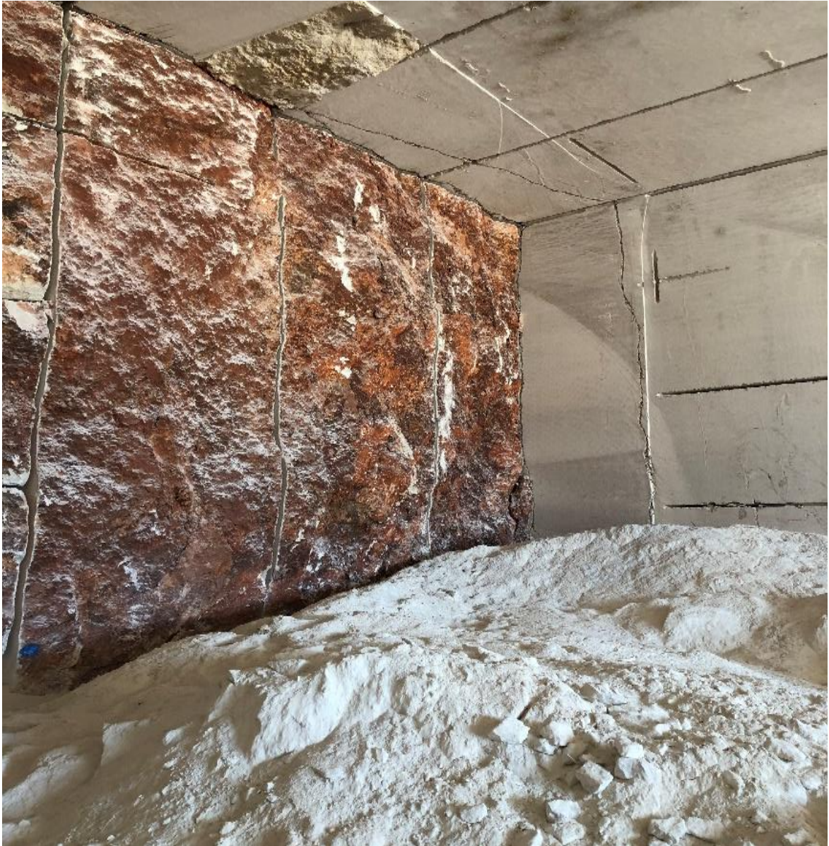
Slika 4-5 Pukotine u podzemnom kopu.
