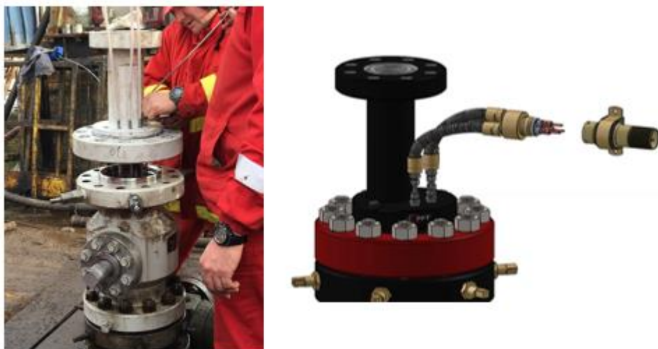
Slika 4-24. Pokrovna prirubnica i trožilni kabel (INA d.d., 2019)
