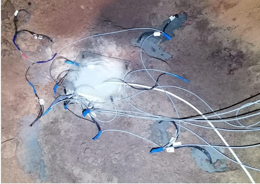
Slika 3-11. Centralna bušotina prije spajanja struje na grijač
