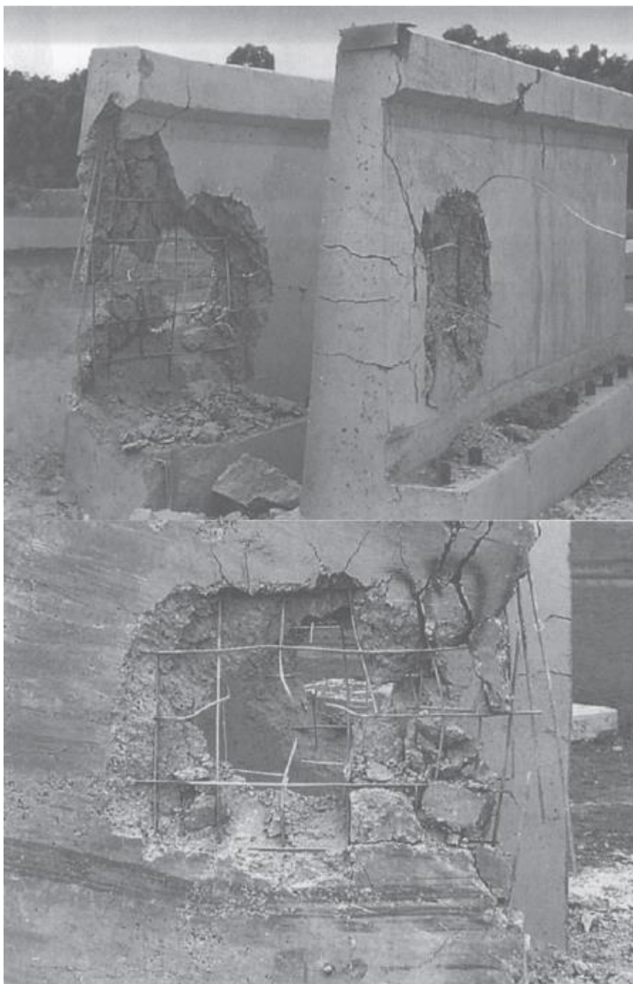
Slika 6-27 Prikaz armiranobetonskih zidova probijenih eksplozivno oblikovanim projektilom (Weickert, 1998)
