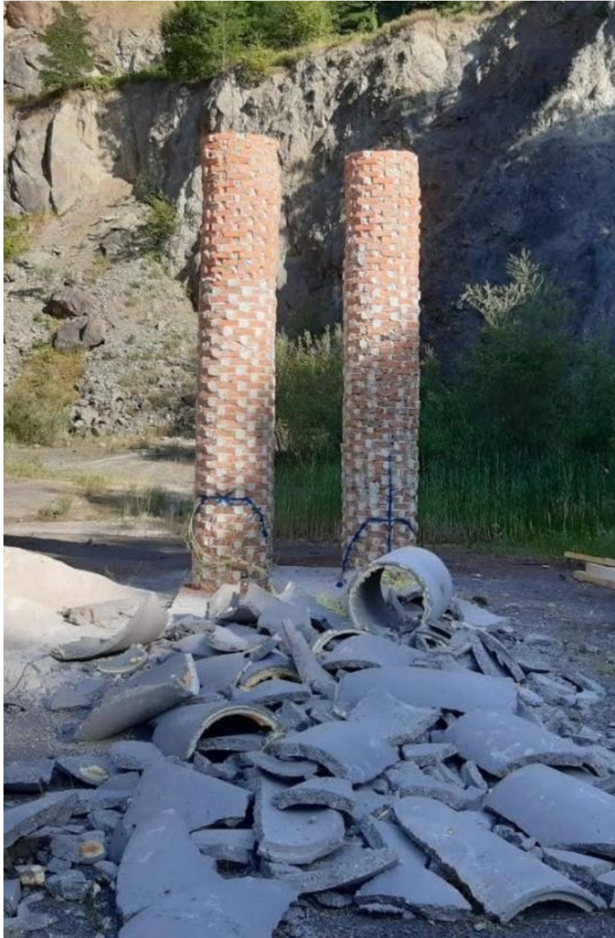
Slika 11-4 Učinak eksploziva na betonskom dimnjaku
