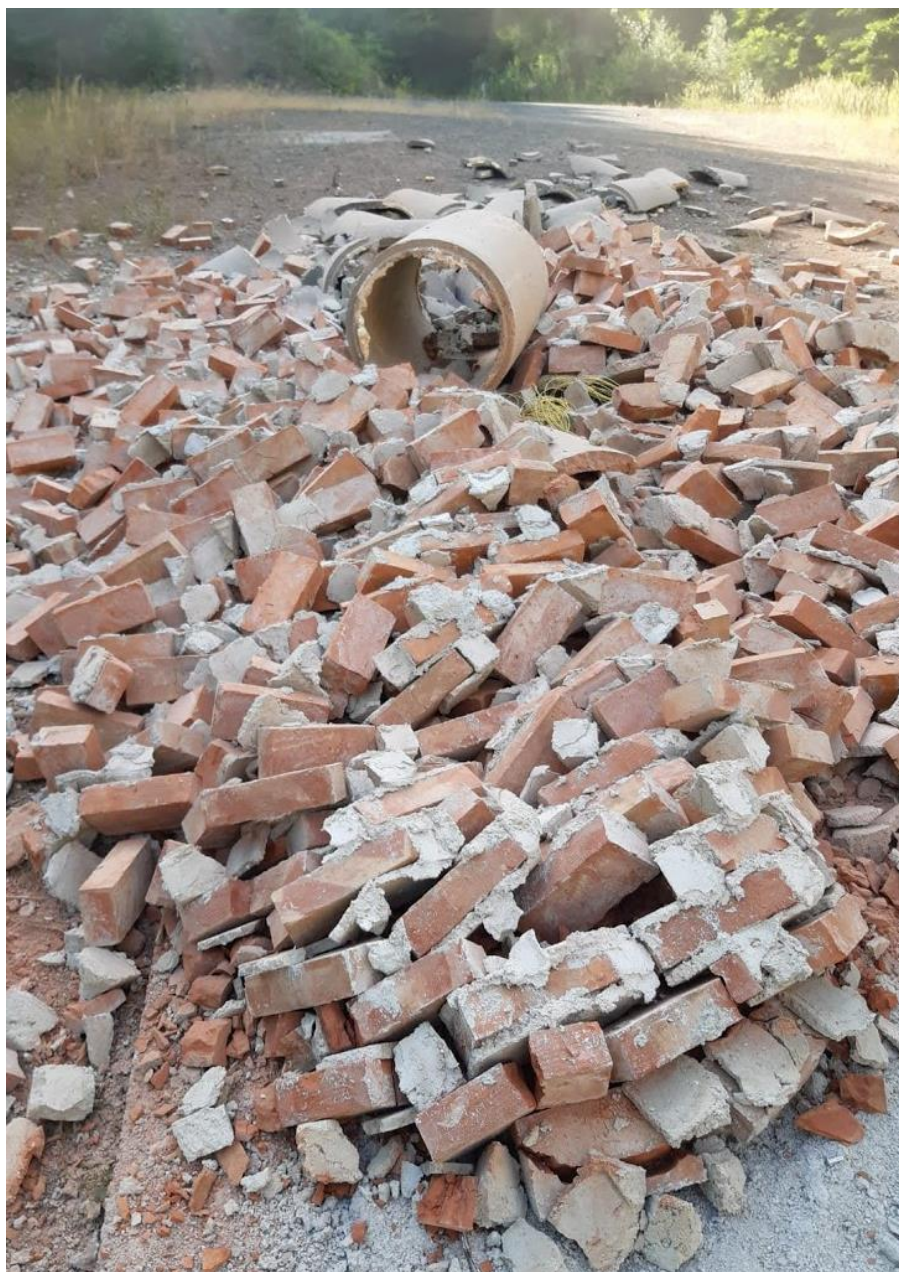
Slika 11-5 Učinak eksploziva na betonskom dimnjaku
