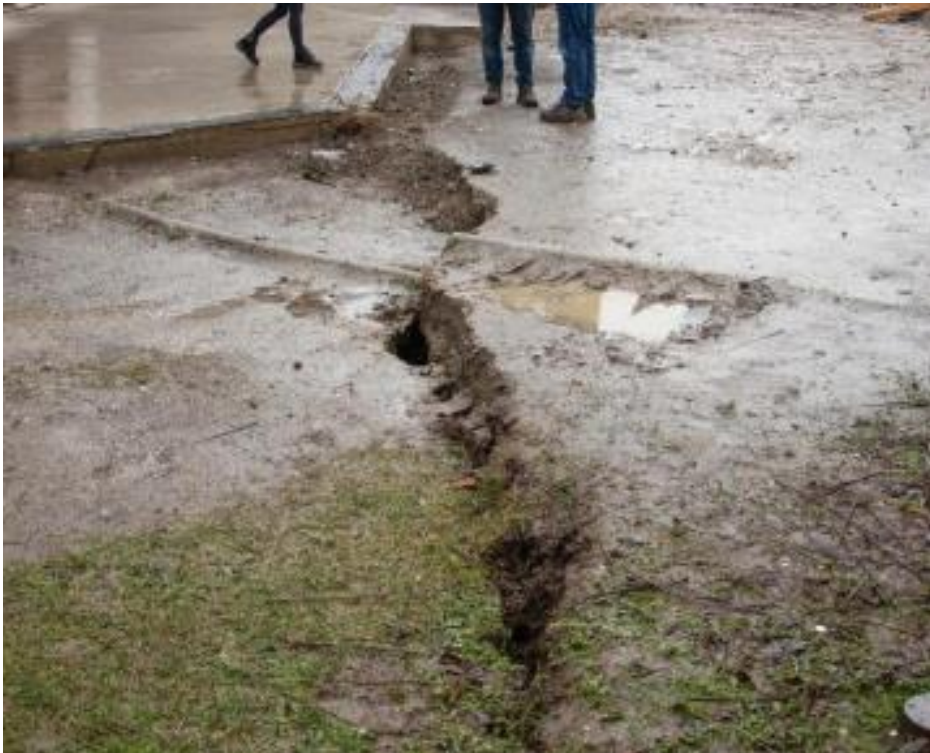
Slika 3-4 Pukotina nastala bočnim razmicanjem (Mihalić Arbanas i dr., 2021)
