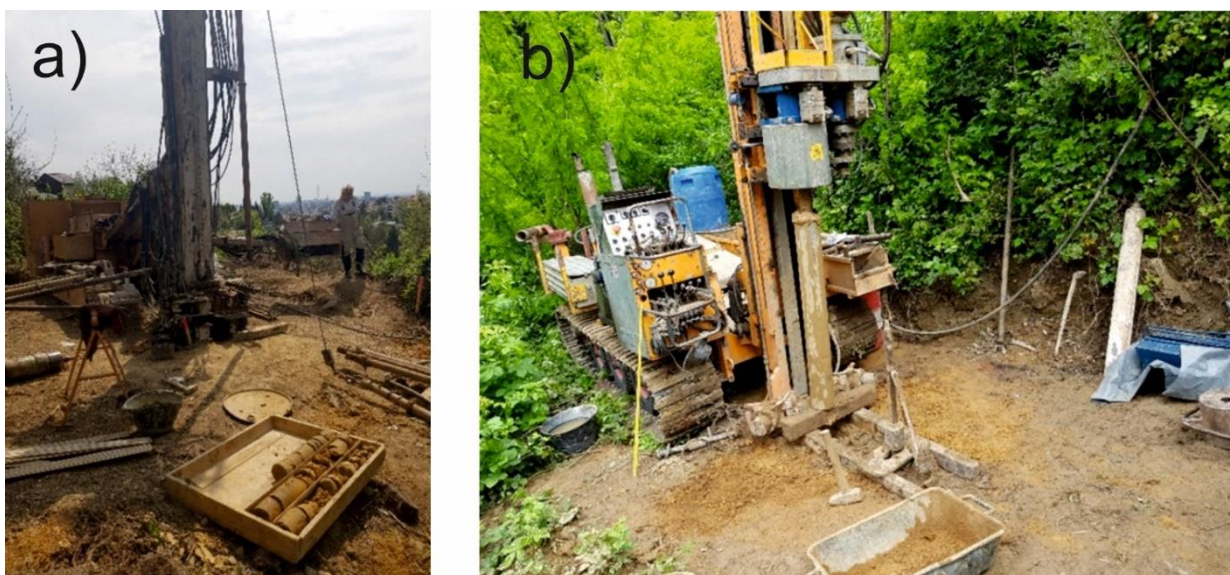
Slika 3.2.1. Bušaće garniture tvrtke MKS Inženjering d.o.o. pri izvođenju bušotina a) Casagrande C6, na bušotini B–3, i b) Geotech 604, na bušotini B–4.
