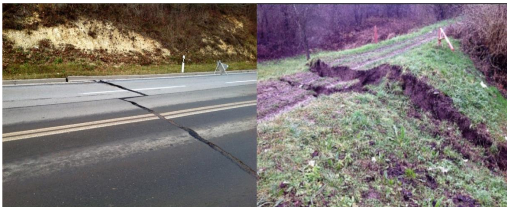
Slika 6.6. Lijevo: Pukotina poprečna na trasu ceste Petrinja–Glina na prijevoju Borovnik koja je sanirana nasipavanjem asfalta., Desno: Pukotina u postranom nasipu na lijevoj obali rijeke Save na izlasku iz sela Palanjak ( https://www.rgn.unizg.hr/hr/izdvojeno/2790-izvjesce-o-zabiljezenim-pojavama-koseizmickih-povrsinskih-deformacija-na-podrucju-pokuplja-i-banovine-nastalih-potresnom-serijom-od-28-12-2020-do-5-01-2021 ).
