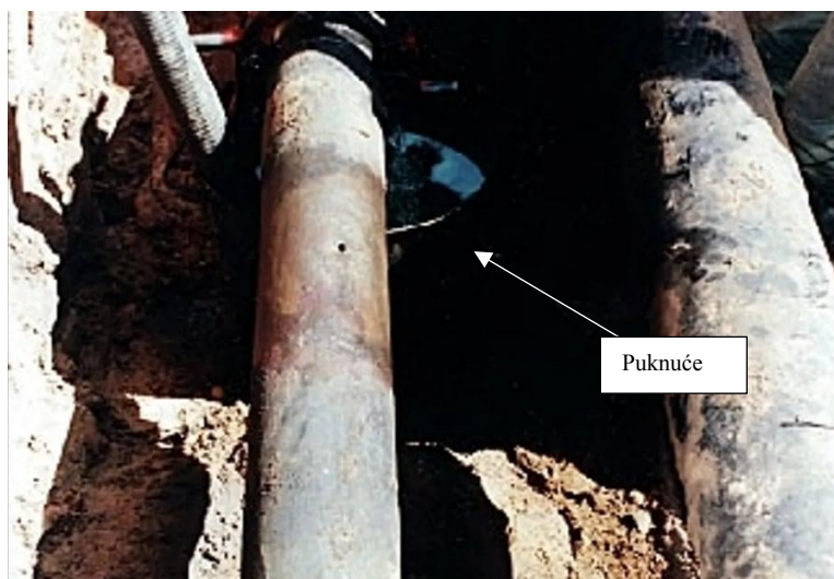
Slika 3-6. Puknuće cjevovoda zbog korozije ( https://www.ogj.com/home/ , 2000)
