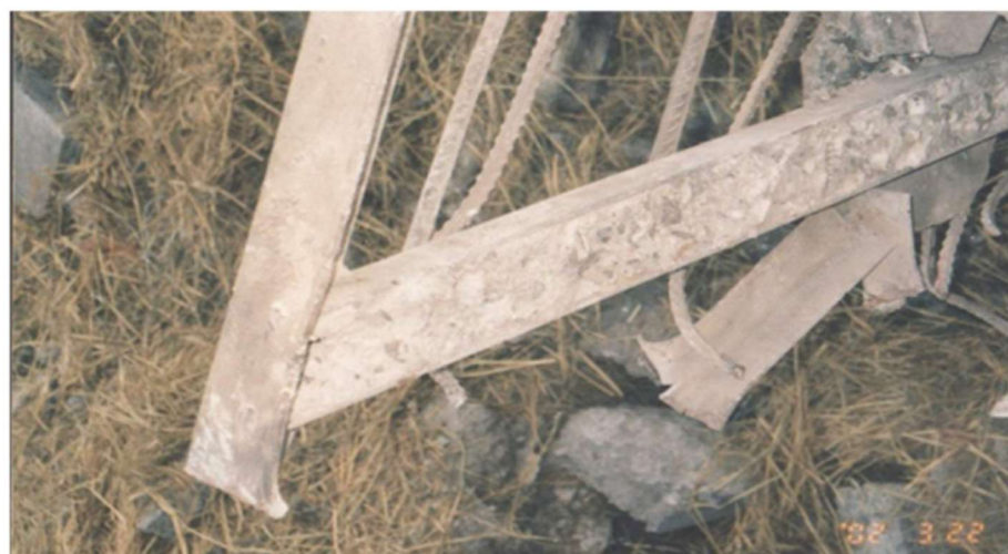
Slika 4-4. Urušena komponenta čelične konstrukcije (Duan et al., 2017)
