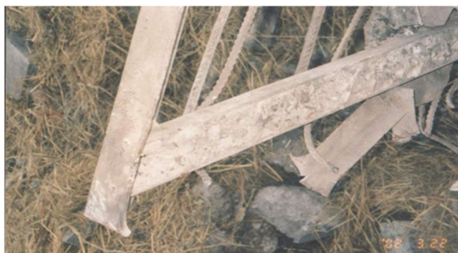
Slika 4-4. Urušena komponenta čelične konstrukcije (Duan et al., 2017)
