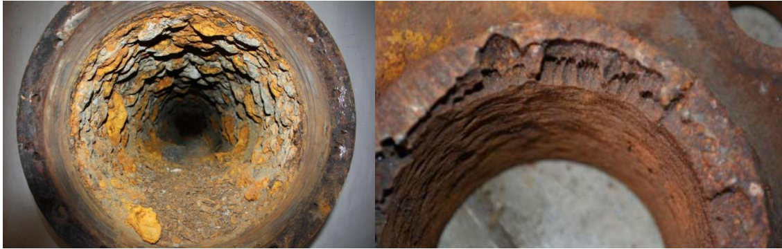
Slika 2-9. Primjeri erozijske korozije (Frazier, 2017.; Bhardwaj, 2020.)
