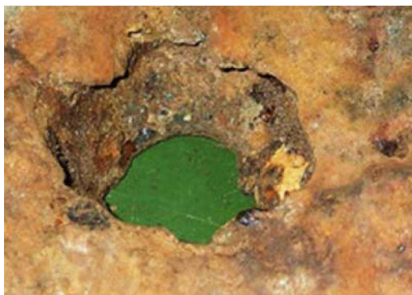
Slika 2-6. Primjer MIC oblika korozije (Bhardwaj, 2020.)
