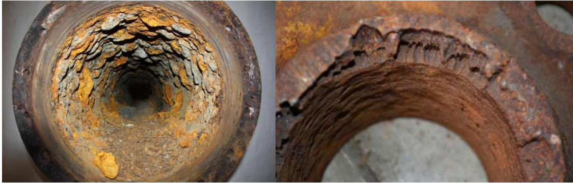
Slika 2-9. Primjeri erozijske korozije (Frazier, 2017.; Bhardwaj, 2020.)
