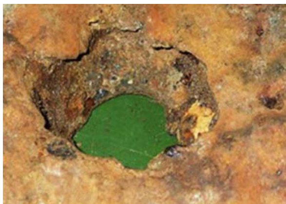
Slika 2-6. Primjer MIC oblika korozije (Bhardwaj, 2020.)
