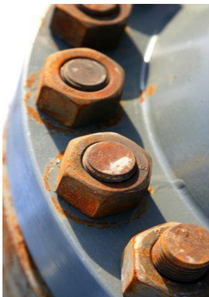
Slika 2-8. Primjer galvanske korozije (Harkin, 2017.)
