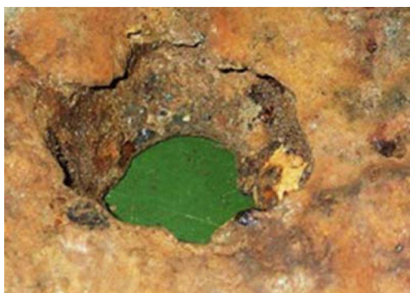
Slika 2-6. Primjer MIC oblika korozije (Bhardwaj, 2020.)
