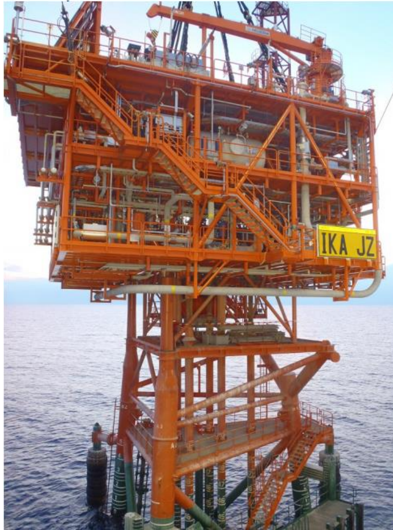
Slika 4-5. Platforma Ika JZ (Fotodokumentacija INAgip)
