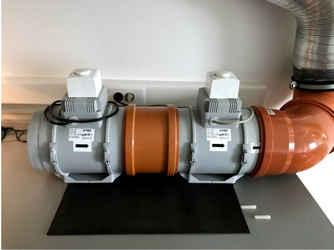
Slika 4-1 Ventilator u laboratoriju
