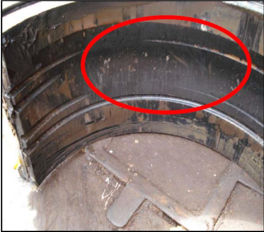
Slika 5-4. Nejednoliko potrošen brtveni element teleskopske spojnice (Upton, 2009)
