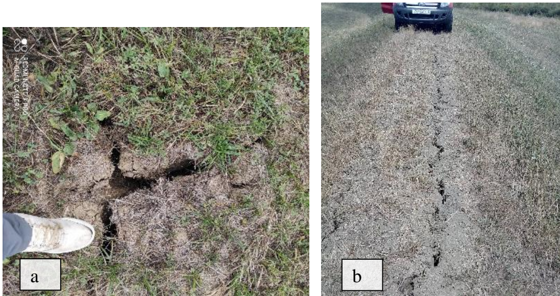
Slika 6.8 Jače sezonske pukotine na nasipu: (a) lokalno; (b) duž krune nasipa
