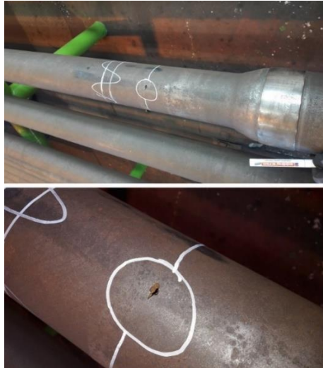
Slika 3-5. Označavanje vizualno otkrivenih oštećenja (CROSCO, 2019)
